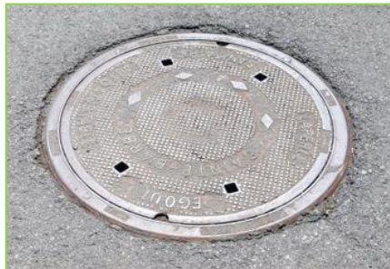
Photo 4 : bouche d'égout sanitaire
